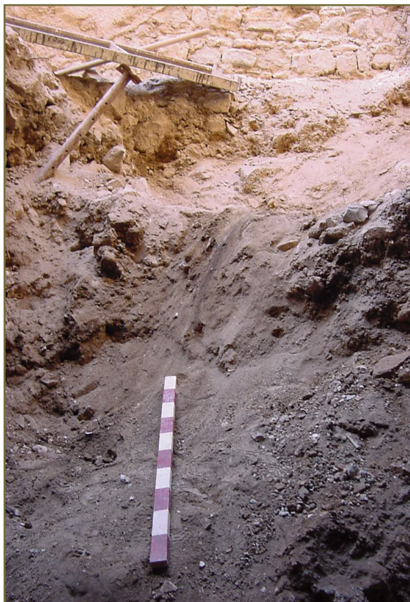
Fotografia 2 – Aspecto do interior do edifício após o aluimento da parede.
