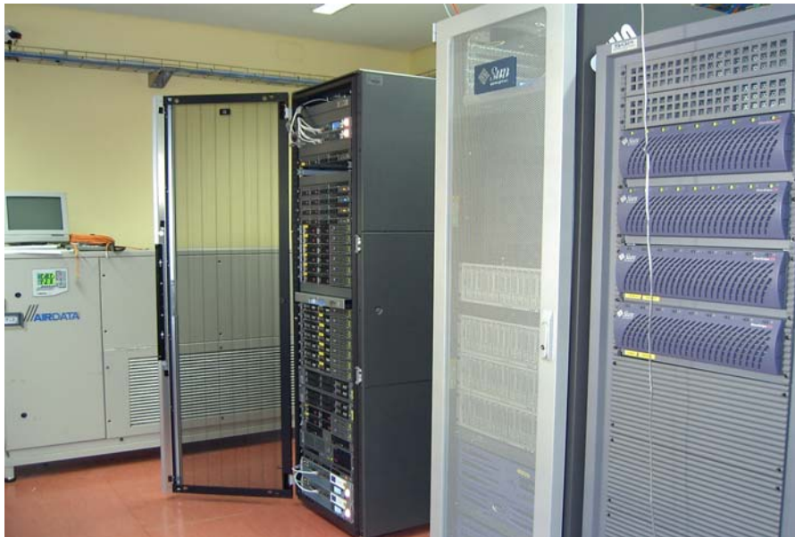
Sala de máquinas del Servicio de Informática y Comunicaciones de la Universidad de Huelva.
