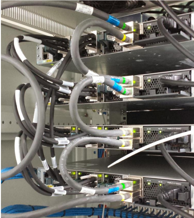
Detalle de la parte trasera de los equipos:
